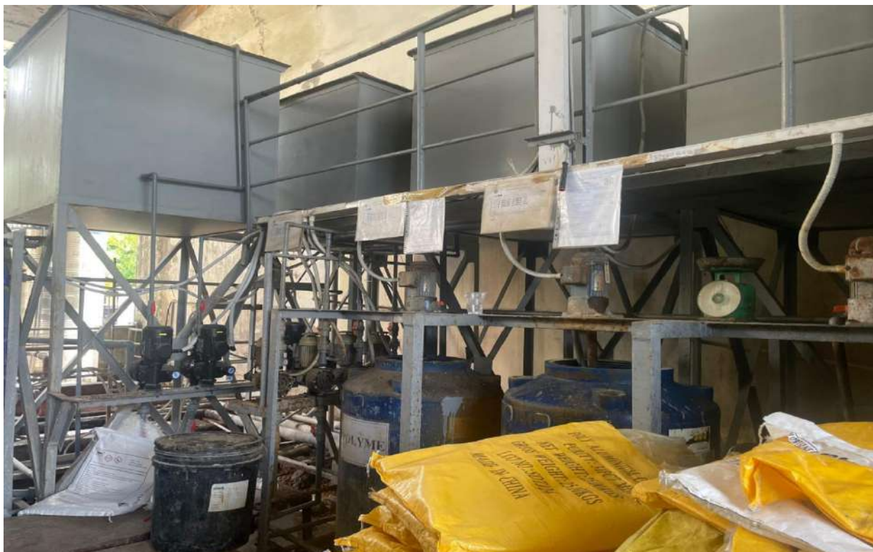
Hình 3.8. Hệ thống xử lý nước thải sản xuất công suất 200m 3 /ngày đêm
