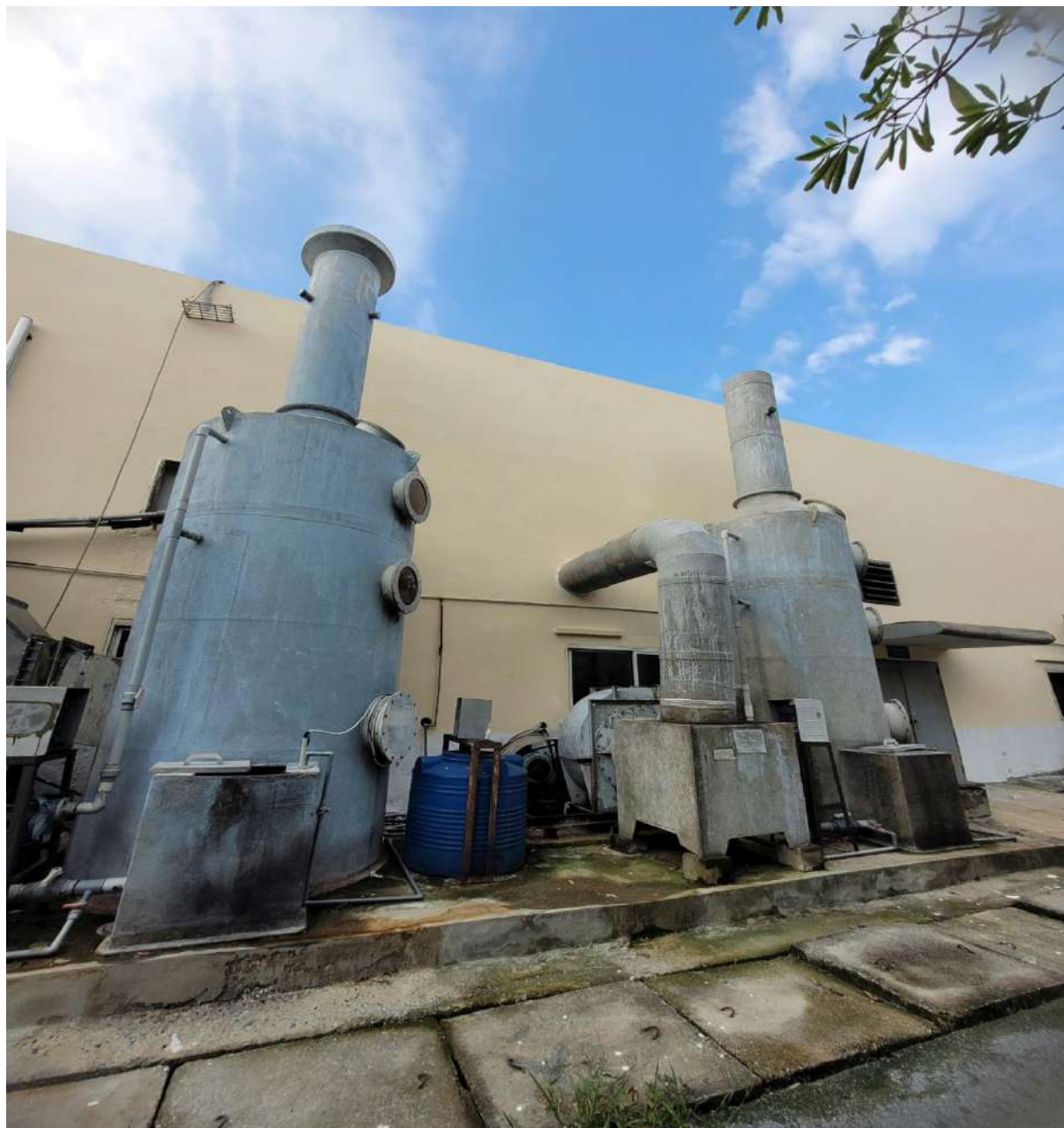
Hình 3.11. Hệ thống xử lý khí thải từ công đoạn mạ hiện tại của dự án
