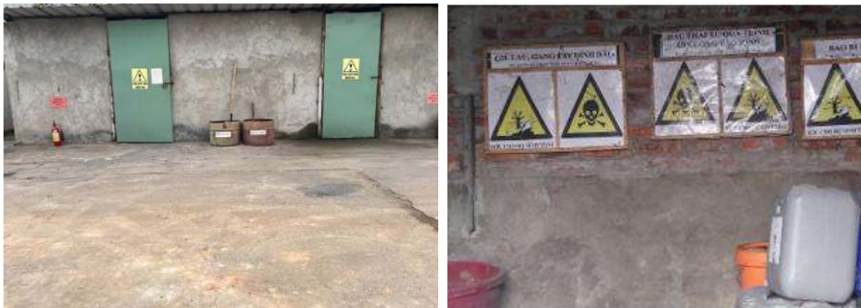
Hình 1.8. Kho lưu giữ CTNH của Nhà máy
