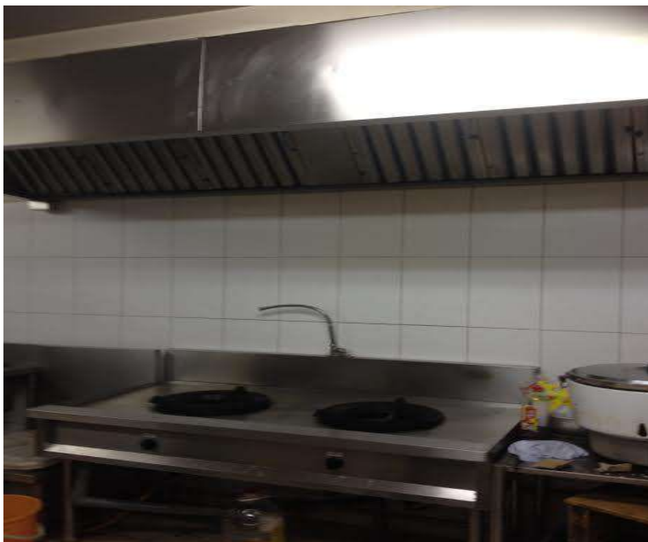
Hình 3.5. Hệ thống hút mùi nhà bếp đã lắp đặt tại Công ty
