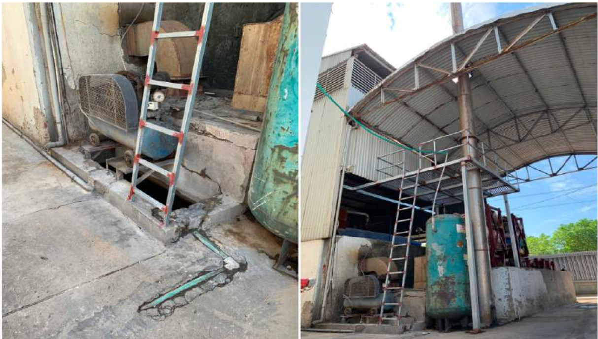
Hình 3.8: Hệ thống xử lý khí thải từ lò hơi đốt củi.
