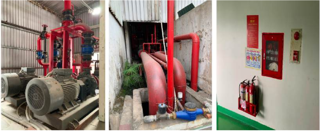
Hình 3.11: Hệ thống phòng cháy, chữa cháy của Cơ sở.
