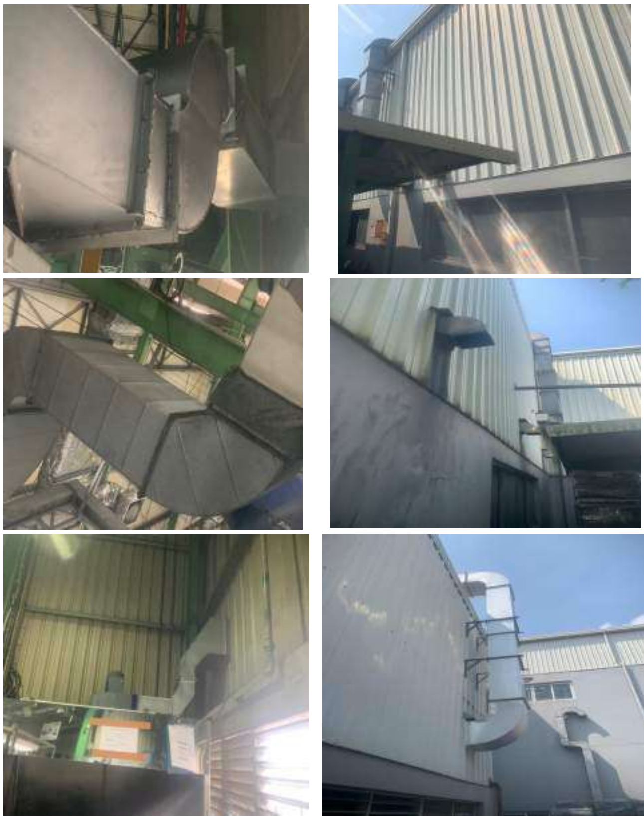
Hình 3.10. Một số hình ảnh hệ thống xử lý khí thải buồng sơn và ống thoát khí tại cơ sở
