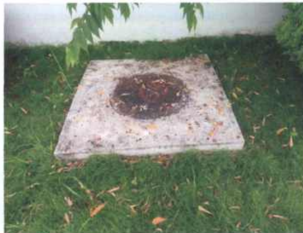
Hình 3-6. Hình ảnh hồ ga đầu nối với cơ sở với hệ thống thoát nước của KCN Thăng Long
