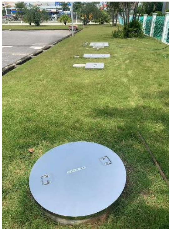
Hình 3-4: Hệ thống xử lý nước thải được xây ngầm của dự án
