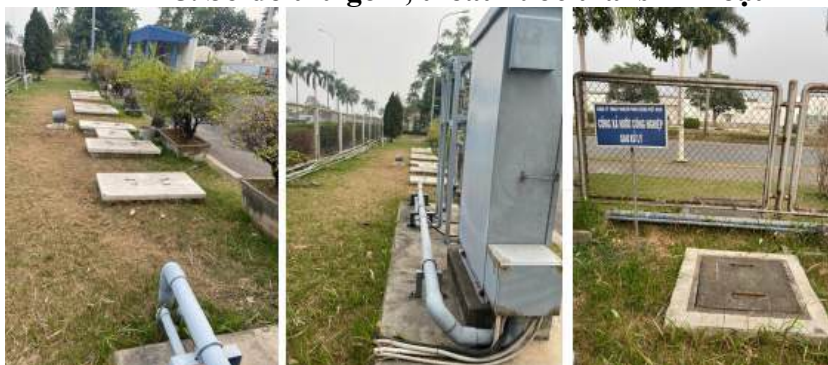
Hình 26. Hệ thống thu gom, xử lý nước thải sinh hoạt
