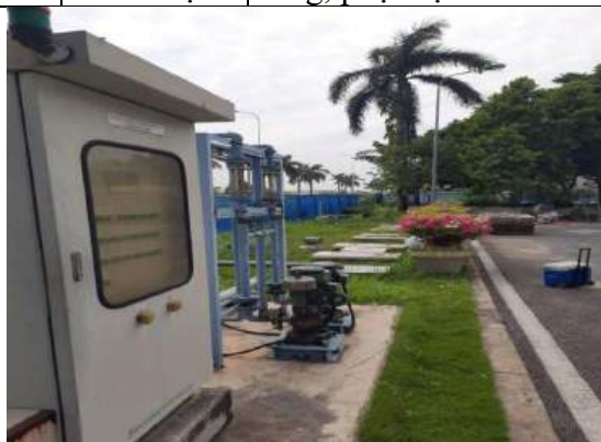
Hình 31. Hệ thống xử lý nước thải sinh hoạt công suất 21 m 3 /ngày.đêm
