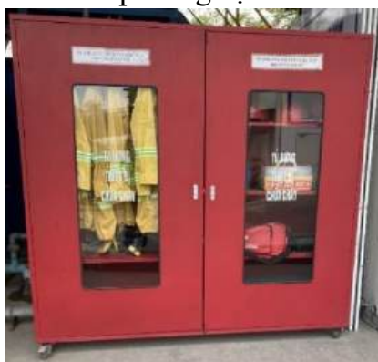
Hình 55. Trang thiết bị phòng cháy chữa cháy
