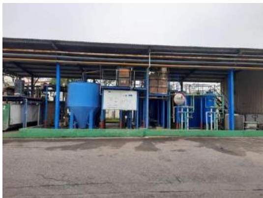
Hình 35. Hệ thống xử lý nước thải sản xuất tập trung của cơ sở
