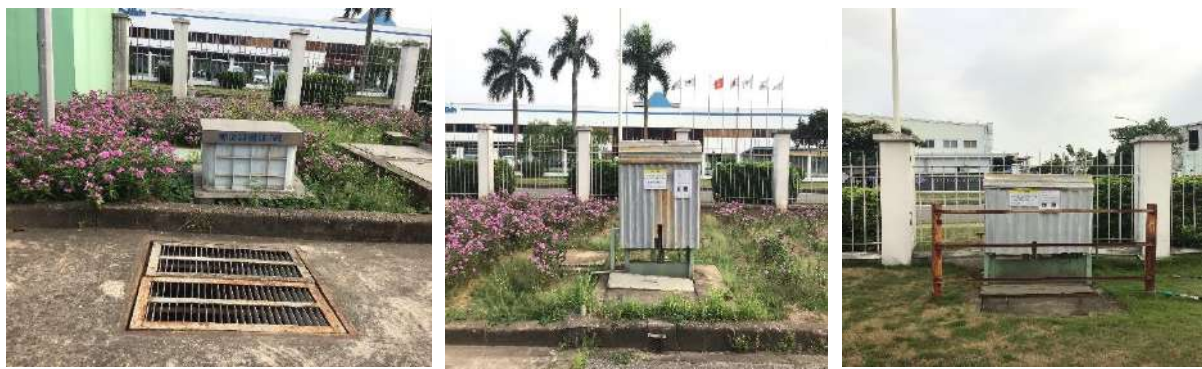
Hình 3. 5. Hình ảnh hệ thống thu gom nước mưa
