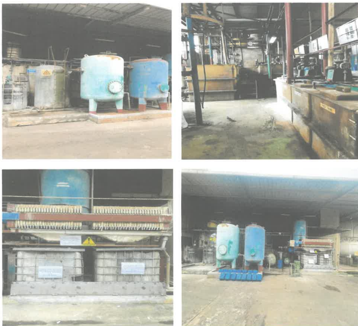
Hình 3.10. Hình ảnh hệ thống xử lý nước thải sản xuất
