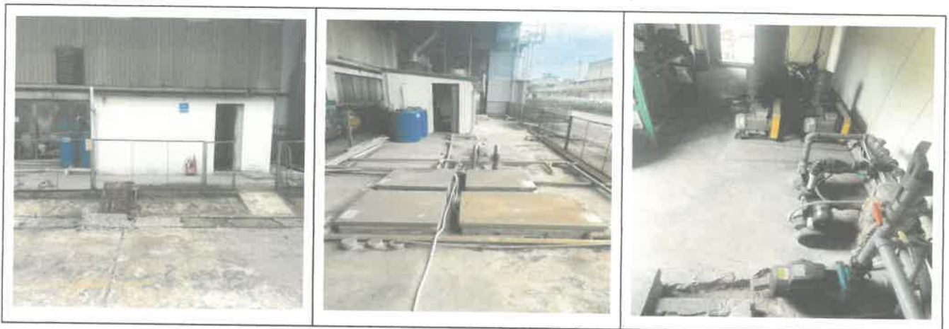
Hình 3.8. Hình ảnh hệ thống xử lý nước thải sinh hoạt
