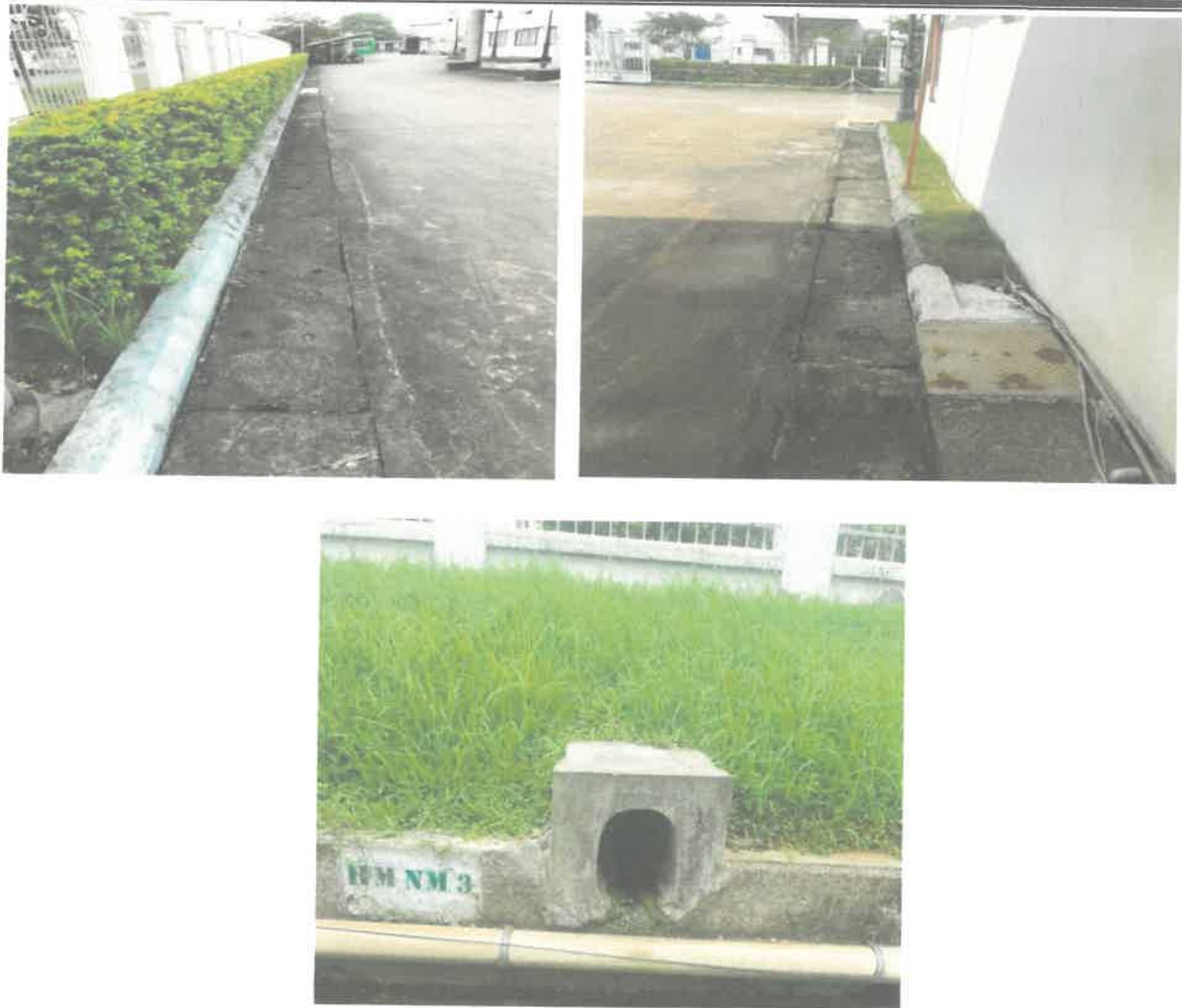
Hình 3.2. Hệ thống thu gom thoát nước mưa
