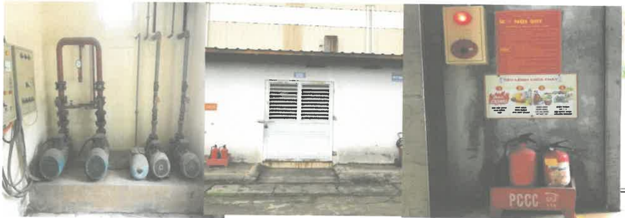
Hình 3.18. Hệ thống PCCC
