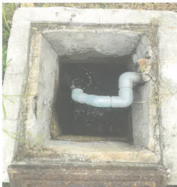
Hình 3.5. Hình ảnh bể đầu nổi NTSH với hệ thống thoát nước KCN
