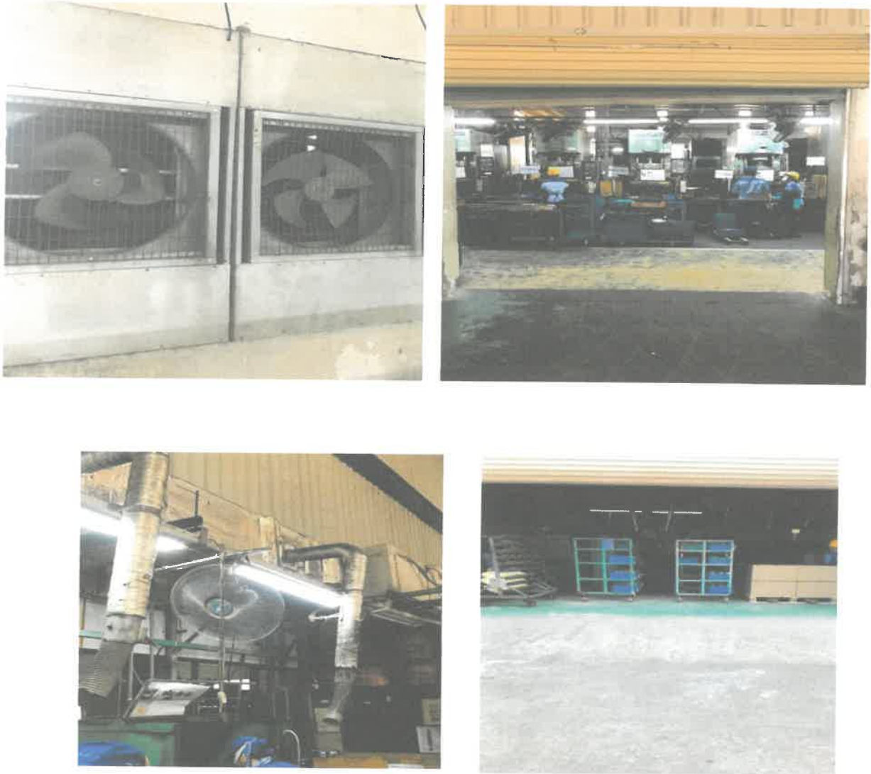
Hình 3.17. Hệ thống thông gió nhà xưởng
